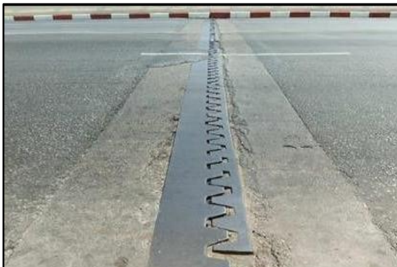
Expansion Joint ပျက်စီးနေပုံ
